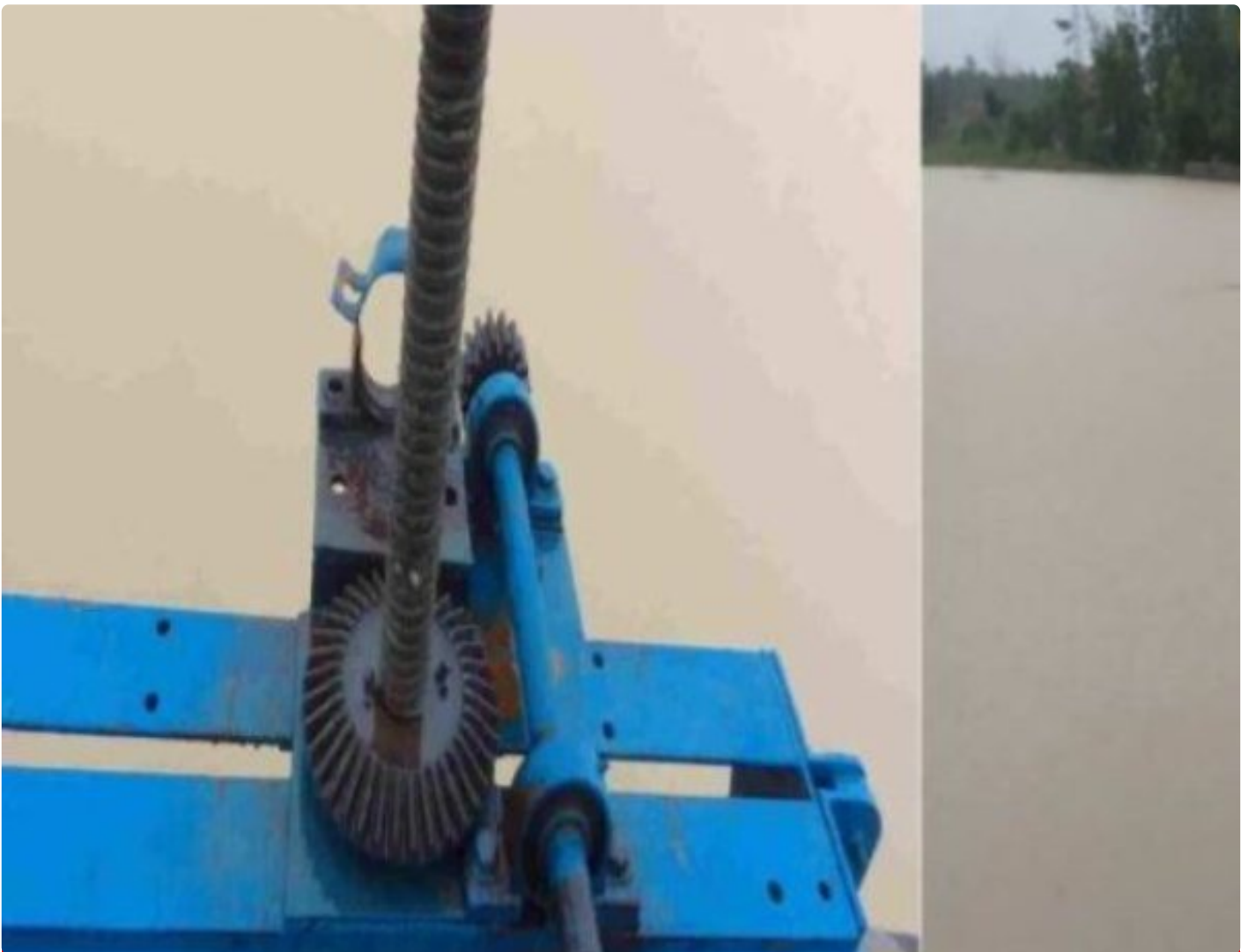
Pintu air Albaret Simpang Mesuji
